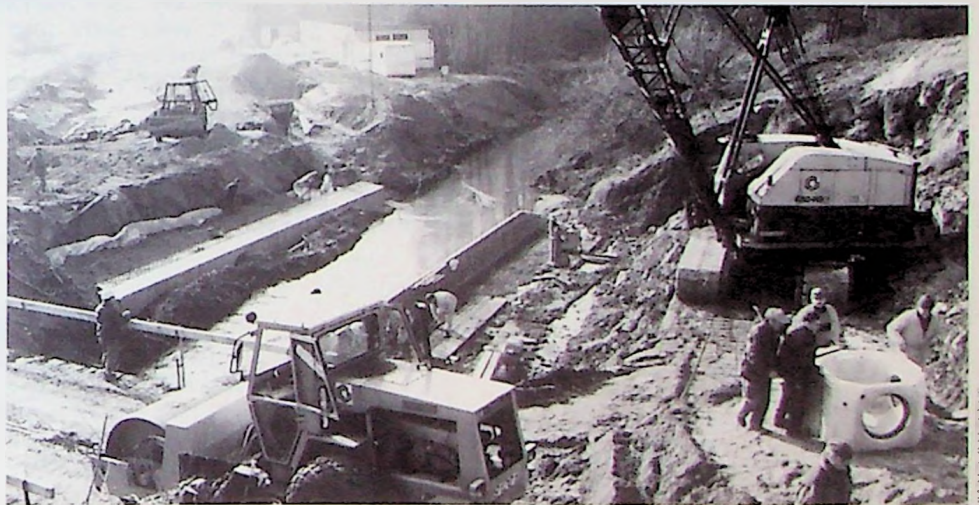
Projet des 7 Ponts : Construction du nouveau pont sur la Dyle et travaux d'aménagement de la voirie de liaison.
