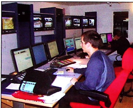
La salle de contrôle, à l'entrée du parking Grand-Place.
