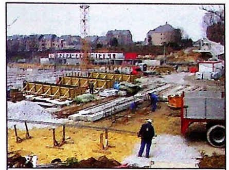
Les poutres sont réalisées sur place. Les armatures sont placées dans les coffrages qu'on aperçoit sur la gauche... coffrages dans lesquels on coule ensuite du béton. Une nuit de séchage et le tour est joué !
