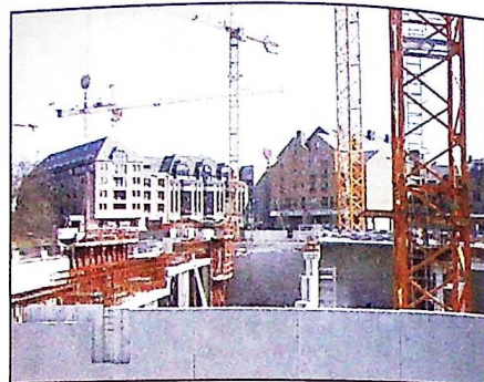
La rue Charlemagne viendra couvrir le niveau -1 du parking. On aperçoit, au fond, les bâtiments de la place de l'Université.
