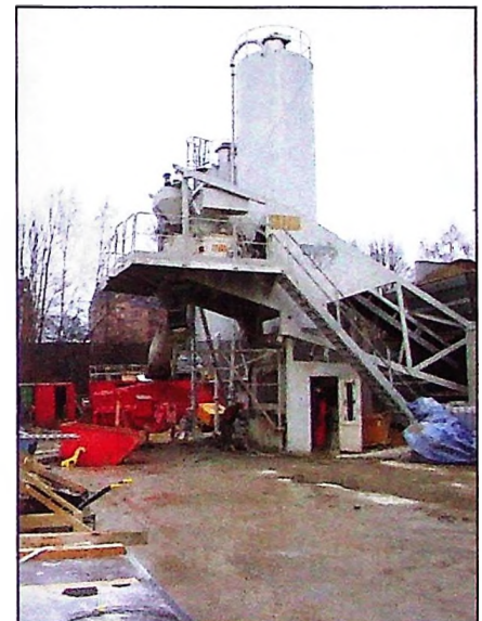
Particularité chez Bouygues : la présence, sur le chantier, d'une centrale à béton qui peut produire jusqu'à 350 m 3 de béton par jour.
