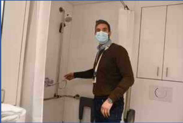
Guillaume Thiry - directeur en charge de l'infrastructure au Centre Hospitalier Neurologique William Lennox (CHNWL) - présente la douche en test, dans la chambre « test ».
