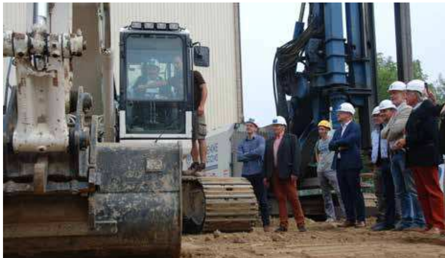
Autour du ministre wallon du Tourisme René Collin, pour symboliquement «poser la première pierre» du futur Gîte d'Étape de Louvain-la-Neuve, les représentants de la Ville, de l'UCL et de l'ASBL «Gîtes d'étape».
