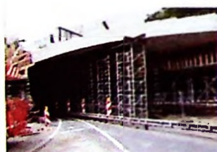
La réalisation de la voûte du pont de l'avenue des Combattants a nécessité la fermeture du pont, les week-ends de juillet.
