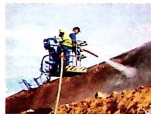
La technique de gunitage consiste à projeter du béton très sec (gunit) sur les talus, pour maintenir ceux-ci en place durant les travaux.
