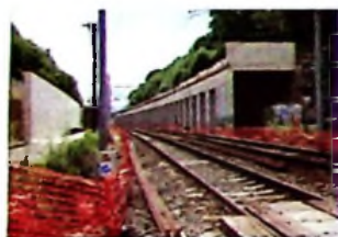
La tranchée couverte est en cours de réalisation, à la rue de Renivaux. La nouvelle route, qui passera au-dessus des voies, devrait être ouverte à la fin de l'année.
